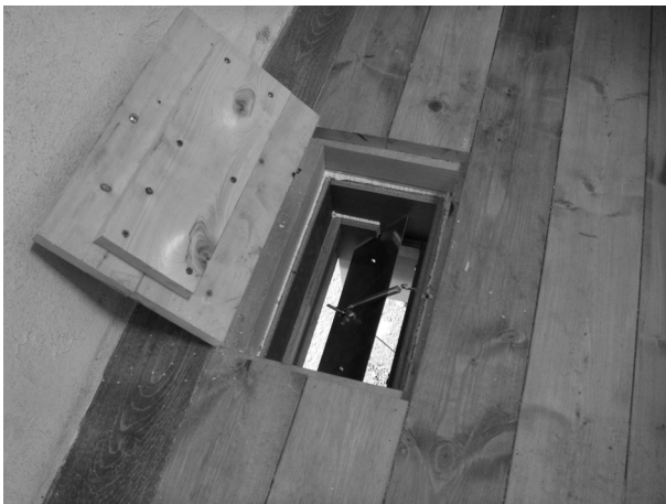
図7 非電化換気孔
